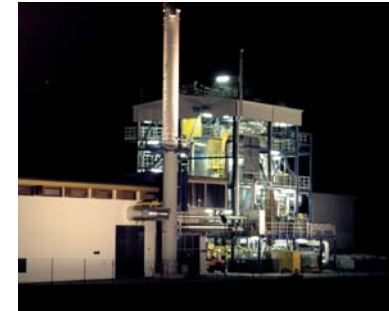
→ Das Kraftwerk liefert regionale Energie aus Biomasse nach Güssing.
