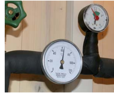
→ Bereits um 9.00 Uhr morgens liefert die Solaranlage 64°C. Energie im Überfluss.
