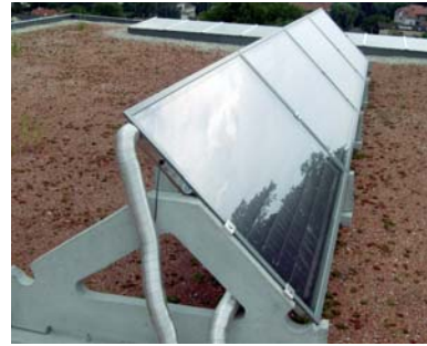
→ Solarkollektoren auf dem Dach versorgen das Haus mit warmem Wasser.
